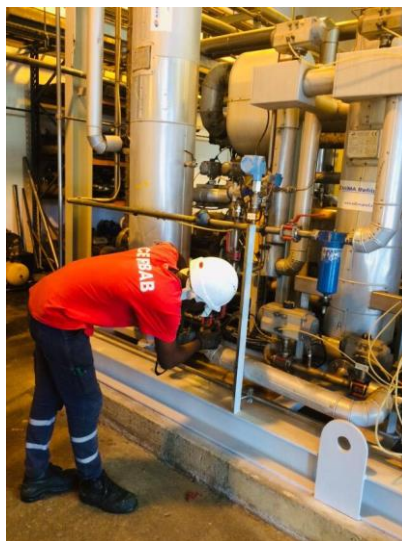
Fig. 6 Operador a verificar os dispositivos do circuito de CO 2
