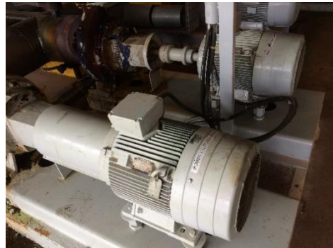
Fig.11 Bombas de água glicolada
