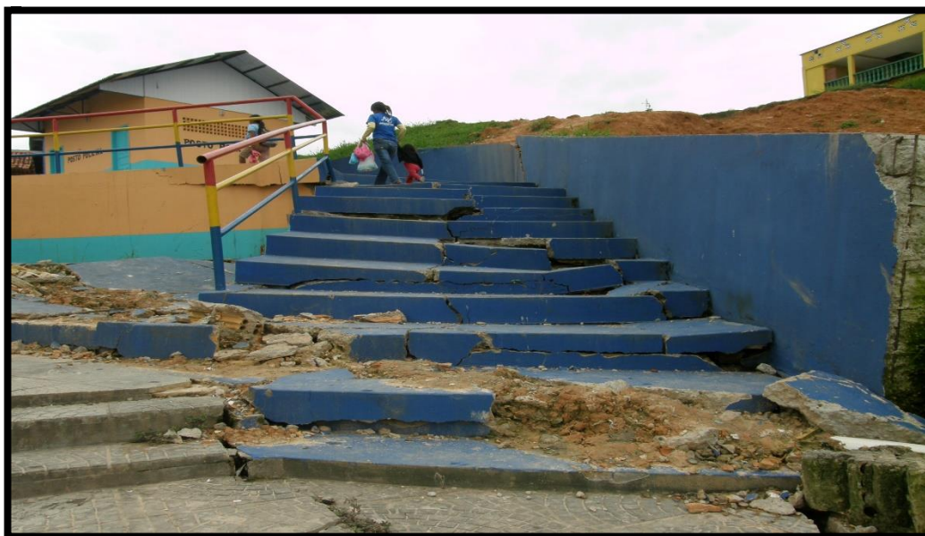
Figura 4: Ação erosiva danificando a estrutura do complexo turístico,
