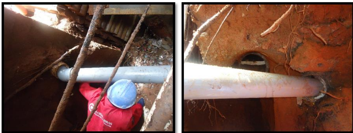
Figura 39: União das tubagens danificadas. (Fonte: O autor)
