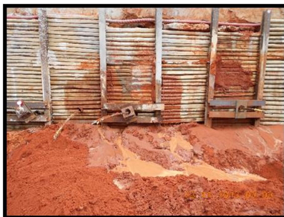
Figura 31: Alagamento do lado escavado. (Fonte: O Autor)
