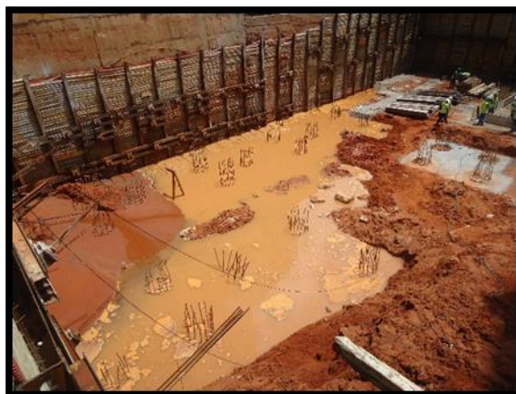
Figura 35: Obra alagada. (Fonte: o Autor)
