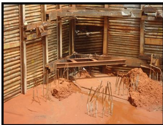
Figura 37: Pranchões de madeira danificados (Fonte: o Autor)
