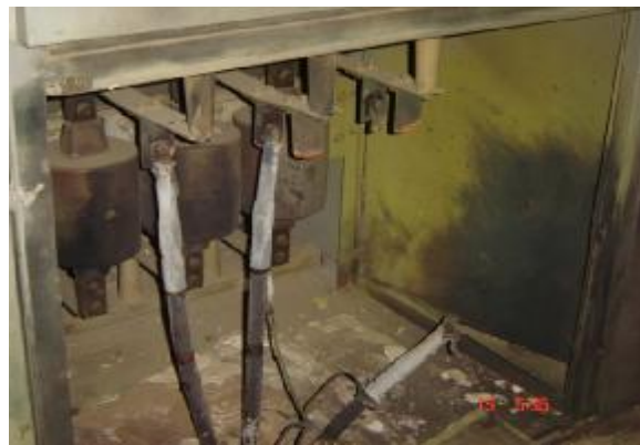
Figura 33: Cabo solto no terminal
