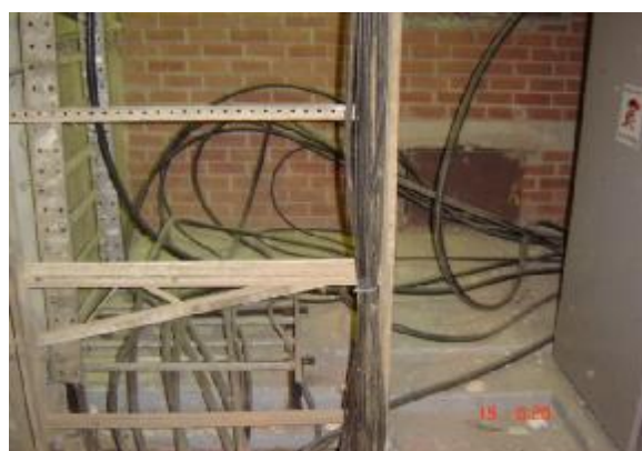
Figura 35: Cabos desprendidos do bandejamento
