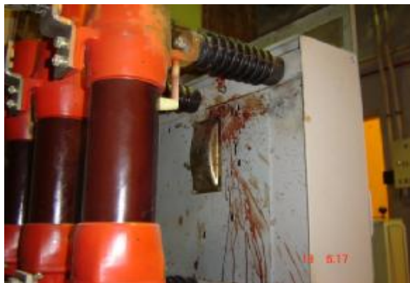
Figura 32: Disjuntor onde originou o curto
